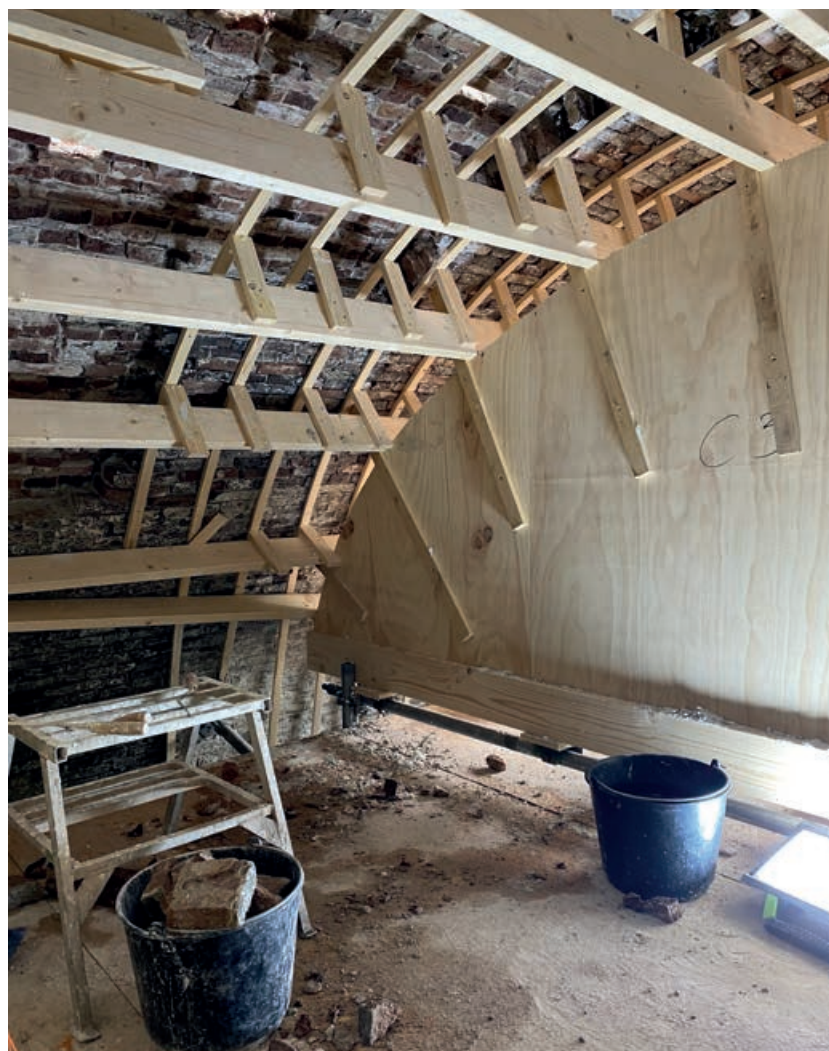
De houten constructie van het formeel. Duidelijk zichtbaar is hoe de houten boog tegen de stenen drukt.
