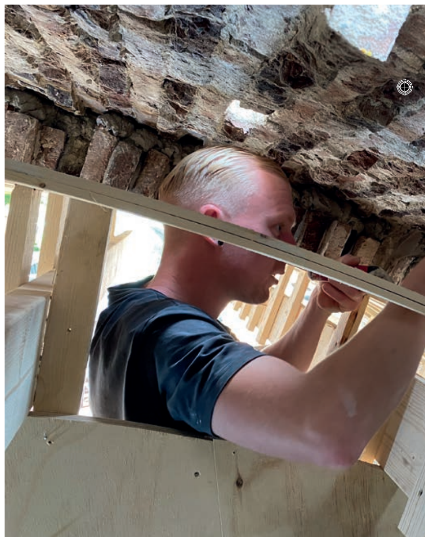
Gijs Filee metselt het binnenwerk weer 'vol en zat' vast aan de nog bestaande buitenkant. Op de plekken waar zonlicht door het gewelf schijnt zal hij ankerstenen zetten.
